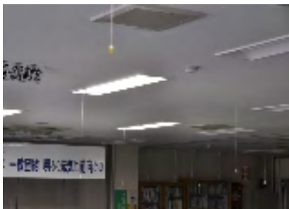
使用箇所のみ点灯 4月 使用頻度の低いエリアの間引き 蛍光灯紐スイッチの取り付け （本社営業所事務所）
